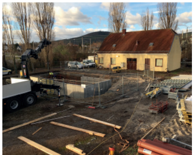
Der Neubau der Sooßer Kläranlage als nachhaltiges Umweltprojekt.
